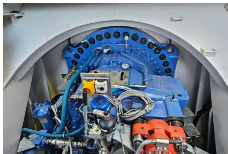
Lidhja e gjeneratorëve të turbinave me erë
